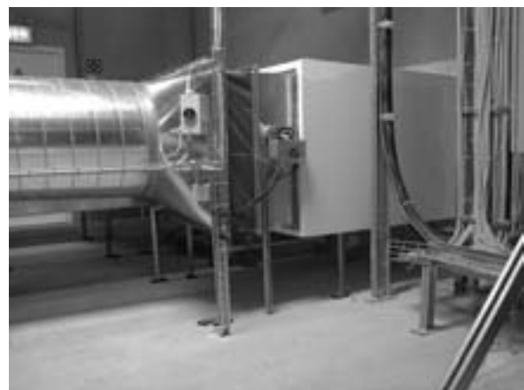
Abbildung 7: Beispiel von Einbaufehlern in der Praxis
